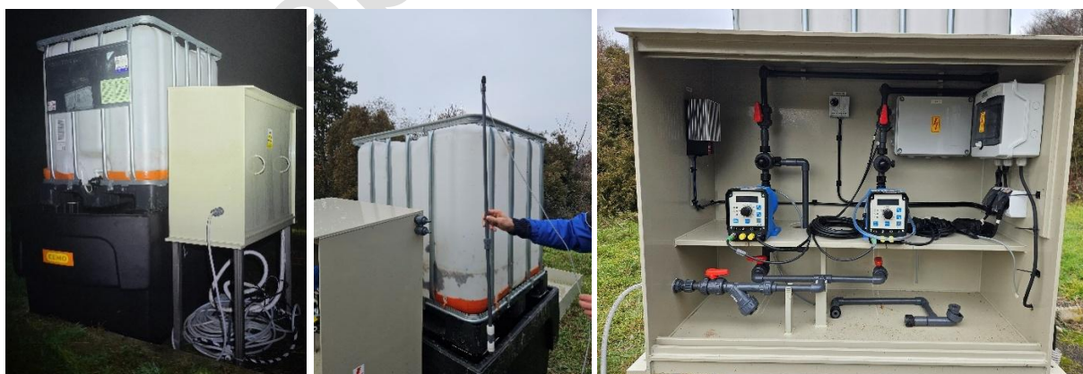
Obr. 10. Dávkovací stanice na ČOV P (700 EO) Fig. 10. Dosing station at WWTP P (700 PE)
