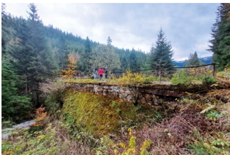
Obr. 12. Vzdušná strana hrádze klauzy Magurka v novembri 2025 Fig. 12. Downstream slope of Magurka splash dam, November 2025
