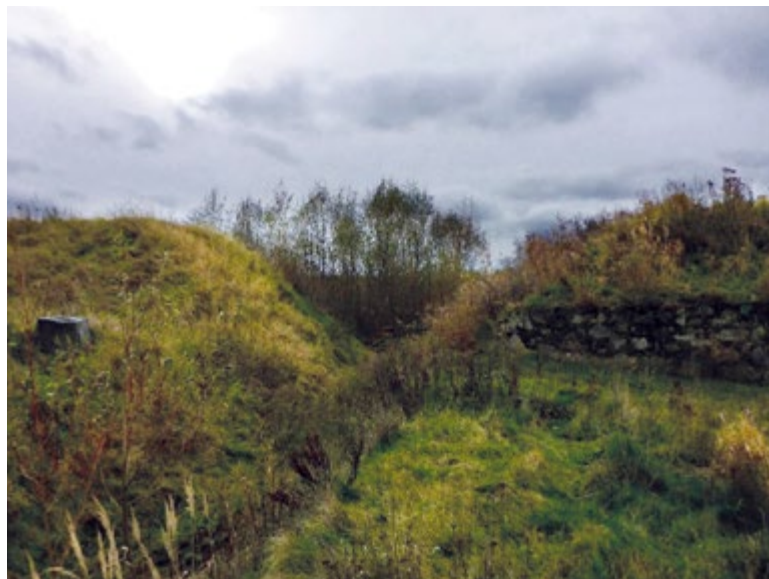
Obr. 6. Průrva v hrázi Mlékovičského rybníka a stav vegetace v prostoru zátopy čtyři roky po protržení, stav v roce 2017 [20]
