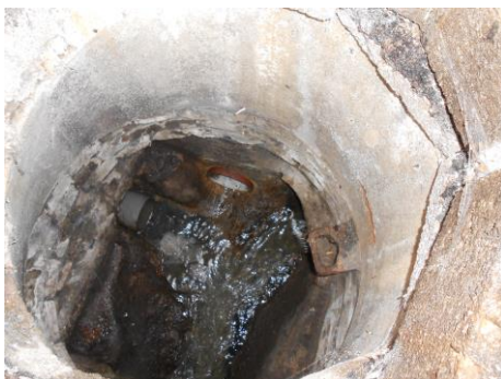
Obr. 2. Ilustrativní záběr odběrového místa na kanalizační přípojce (Zdroj: archiv VÚV TGM)
