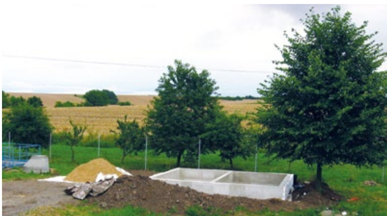
Obr. 3. Příklad výstavby základní konstrukce dvou RB jednotek pro zajištění střídavého provozu napouštění, odvodnění a stabilizace kalu z usazovací nádrže kořenové ČOV, Česká republika
