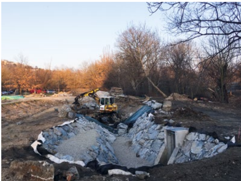
Obr. 4. Stav zemních prací k 1. 3. 2023 (pohled na východ, v popředí se rýsuje budoucí jezerní pánev s již usazeným požerákem)
