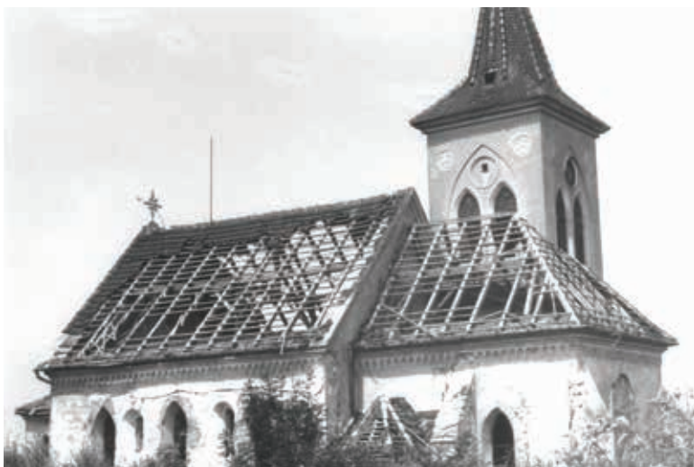
Obr. 4. Mušovský kostel měl být zbořen současně se zatopenou obcí. Jeho záchrana se podařila na poslední chvíli zásluhou skupiny studentů z katedry dějin umění Filozofické fakulty, kteří objevili v kostele na nejstarší románské zdi pod nánosy novějších omítek fresky. Stav kostela v době prvního napouštění nádrže. (Foto: osobní archiv I. Příbylové) Fig. 4. The Mušov village church was to be demolished at the same time as the flooded village. It was saved at the last minute thanks to a group of students from the Department of Art History at the Faculty of Arts, who discovered a fresco on the oldest Romanesque wall in the church, under layers of newer plaster. (Photo: personal archive of I. Příbylová)
