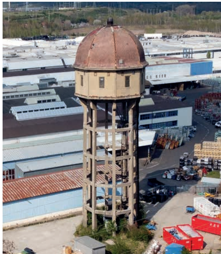
Obr. 12. Věžový vodojem bývalé sklárny v Bílině-Chudečicích je příkladem užití subtilní otevřené nosné konstrukce pro nesení nádrže (Foto: M. Postl) Fig. 12. The elevated water tank of the former glass factory in Bílina-Chudečice is an example of the use of a subtle open support structure for carrying a tank (Photo: M. Postl)
