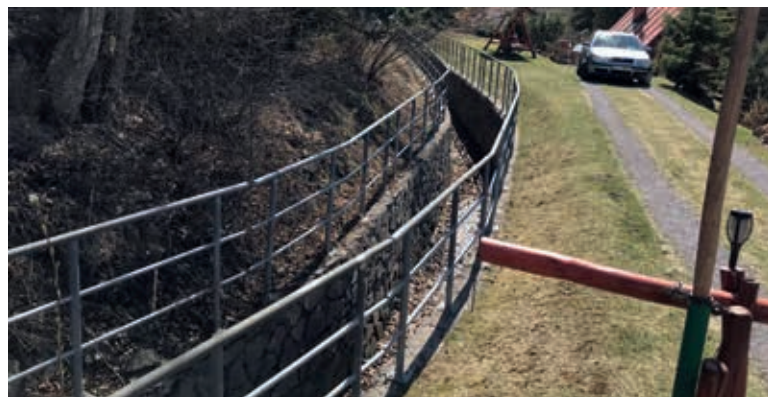
Obr. 9. Nevhodná rekonštrukcia jedného zo zberných jarkov (Foto: S. Červeň)
