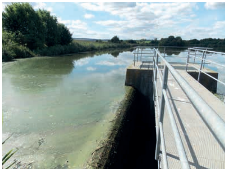
Obr. 9. SN Želeč je deklarována coby ochranná, ale provozována je jako zcela napuštěná (AQUATIS, a. s.) Fig. 9. Dry polder Želeč, referred to as a reservoir with flood protection purposed, but operated as fully filled (AQUATIS, a. s.)
