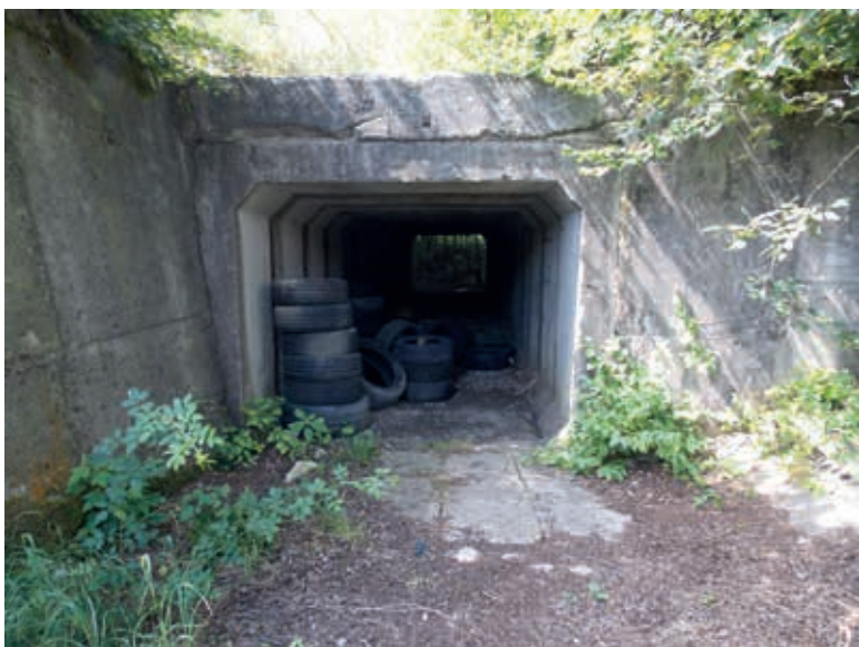
Obr. 8. Uskladněné pneumatiky v odpadní chodbě od bezpečnostního přelivu SN – Všemina II (AQUATIS, a. s.) Fig. 8. Used tyres dump in the outflow corridor downstream the safety spillway SN – Všemina II (AQUATIS, a. s.)
