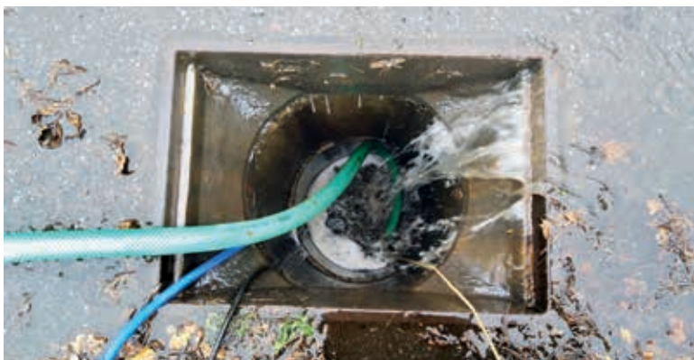
Obr. 5. Pohled na utěsněnou vpust' (lokalita 2) Fig. 5. View of a sealed drain (locality 2)
