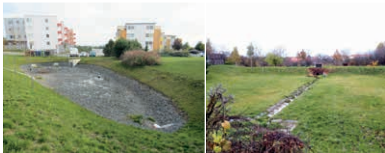
Obr. 4. Suché nádrže pro zachycení odtoku ze zpevněných ploch a následné infiltrace do půdního profilu. Lokalita Kyje (vlevo), Vinoř (vpravo), (Foto: VÚV TGM, v. v. i.)
