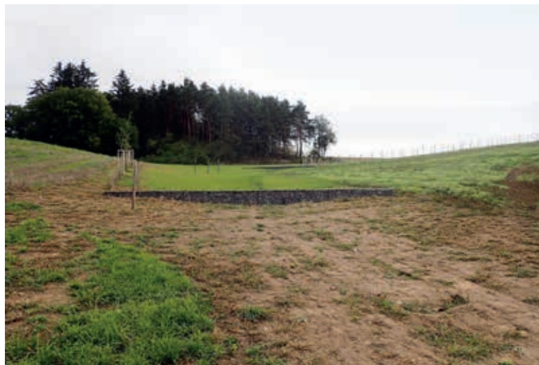
Obr. 2. Gabionová přehrážka v dráze soustředěného povrchového odtoku [2]
