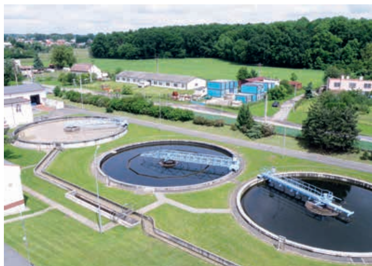
Obr. 3. Čistírna odpadních vod
