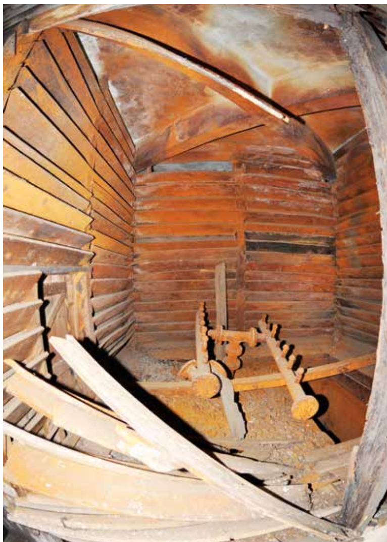
Obr. 5. Pozůstatky technologie na odstranění železa z upravované vody ve věžovém vodojemu v Uherském Hradišti (archiv projektu, 2018)
