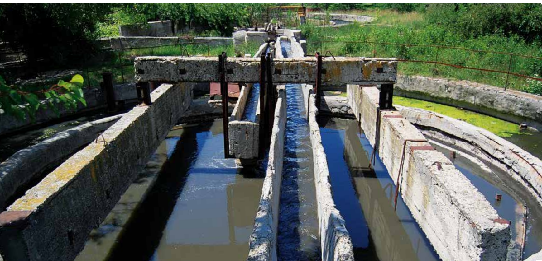
Usazovací nádrž v ČOV Cahul představuje typickou sovětskou konstrukci
