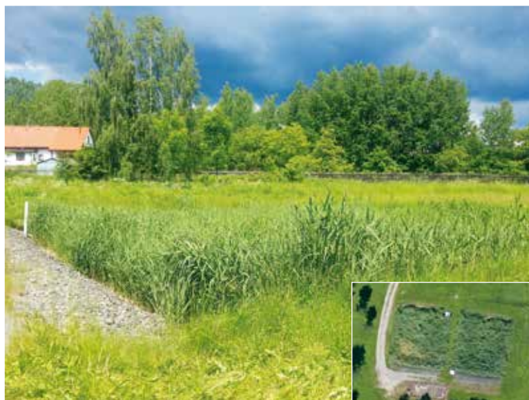
Obr. 1. Pohled na levé kořenové pole čistírny Bezděkov pod Třemšínem a letecký pohled na celou kořenovou čistírnu
