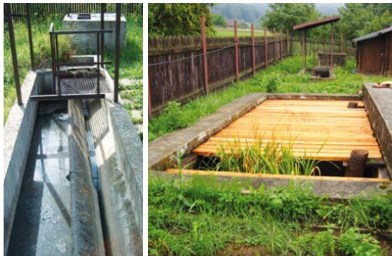
Obr. 3. Šterbinový lapák písku (vlevo) a pohled na usazovací nádrž s boční vyhřívací komorou (vpravo) komunální kořenové ČOV
