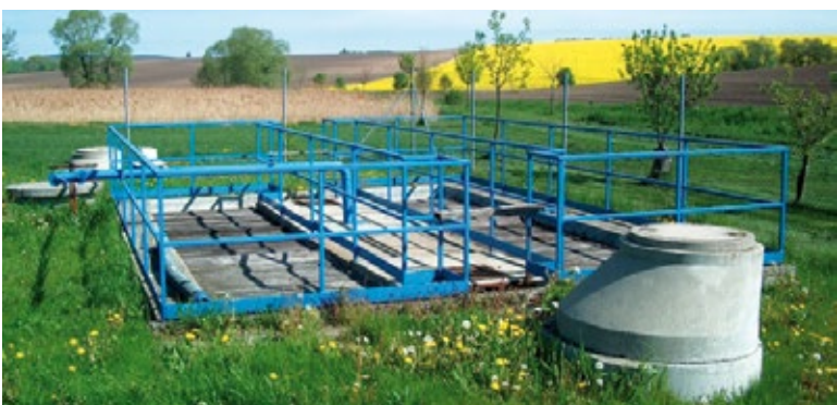
Obr. 2. Šterbinová usazovací nádrž komunální kořenové ČOV
