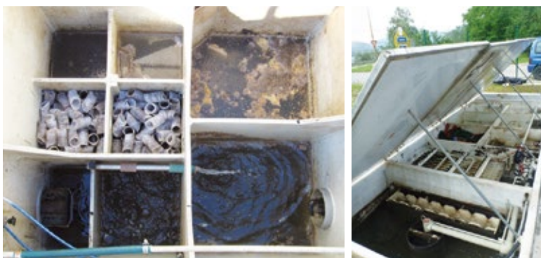
Obr. 1. Pohled na jednotlivé sekce anaerobně-aerobních ČOV (vlevo pro 5 EO, vpravo pro 200 EO)
