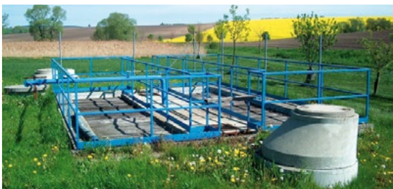
Obr. 2. Šterbinová usazovací nádrž komunální kořenové ČOV
