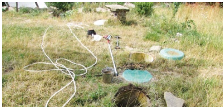
Obr. 4. Příklad sledovaného biologického vícekomorového septiku domovní kořenové ČOV – umístění na pozemku, přístupové otvory
