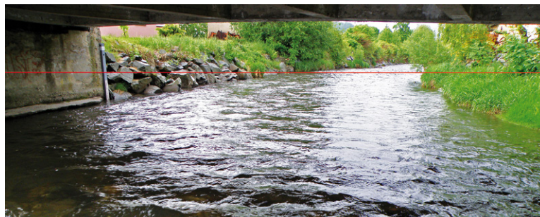
Obr. 8. Vodoměrná stanice Desná-Rapotín s vyznačením nejvyššího zaznamenaného vodního stavu (120,5 cm), pro který byl dopočten odpovídající průtok s využitím Chézyho rovnice
