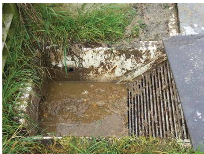
Obr. 1. Nesprávná instalace česlí Fig. 1. Incorrect installation of screen bars
