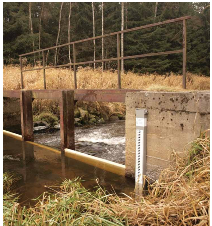
Obr. 2. Vodoměrná stanice na Kateřinském potoce osazená měrným přelivem za využití stávajícího objektu Fig. 2. Stream gauge on Kateřinský creek fitted by weir
