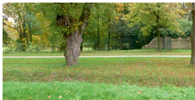
Obr. 6. Narušená zeď zámeckého parku pod identifikovanou drahou soustředěného odtoku
