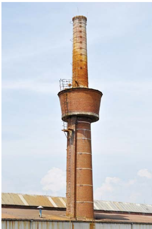
Obr. 5. Tovární komín s vodojemem v Mělníku Fig. 5. Factory chimney with a water tank in Mělník
