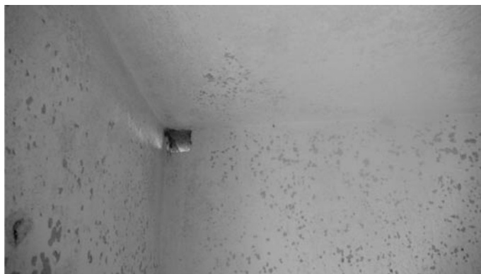
Obr. 2. Větrací otvory ničím nechráněné, uvnitř (foto J. Hubáčková)
