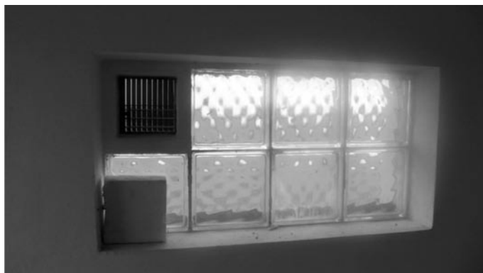
Obr. 3. Okenní otvor zazděný luxfery a žaluzií a polystyrenový hranol
