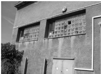
Obr. 1. Pohled na manipulační komoru s porušenými okny (luxfery)
