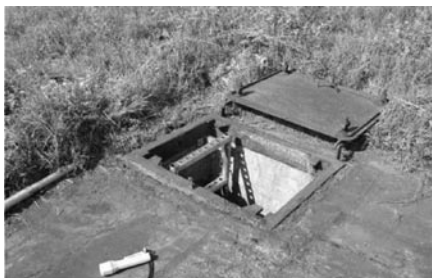
Obr. 2. Vstup do akumulační nádrže přímo v rohu ploché střechy
