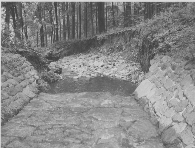
Obr. 2. Nátrž pod upraveným úsekem
