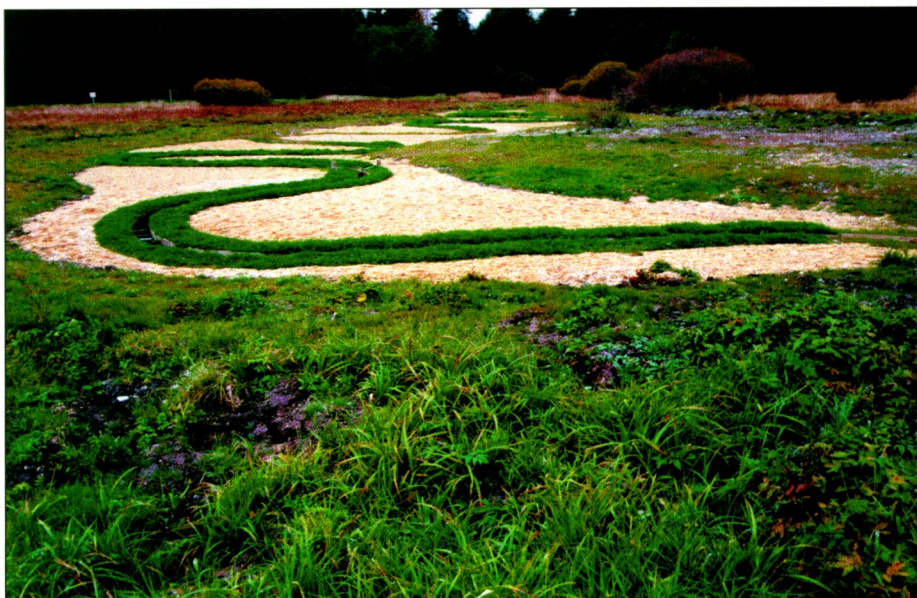
Obr. 6. Pohled na realizované meandry odchovného koryta v roce 1997: obedněný průtočný profil bude zprovozněn po prokořenění kolmých břehů lipnicí; světlá infiltrační zóna bude ohumusována a oseta po dozrání kompostu
