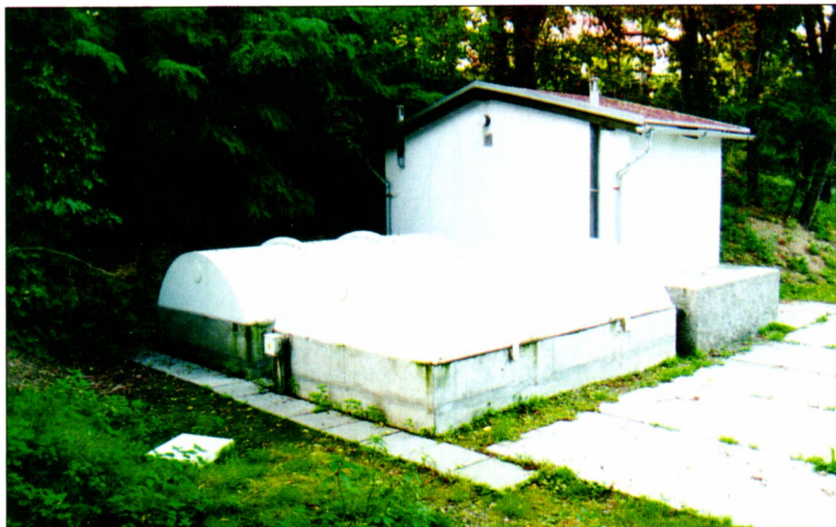
Čistírna odpadních vod s přerušovaným provozem v Křečhoři u Kolína (návrhová kapacita 500 až 550 obyvatel, sestava dvou reaktorů – DIBLOK, reaktory jsou překryty poklopy (k článku ing. Justa – 2x foto autor)
