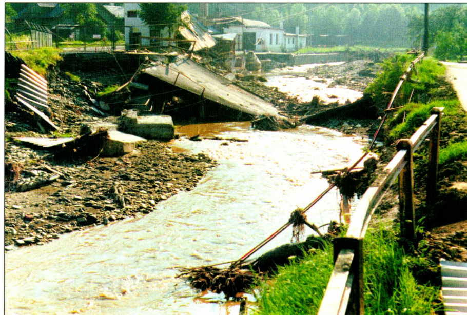
Opavice v Hynčicích – destrukce koryta, mostu a okolních staveb (stav po základním vyčištění koryta)
