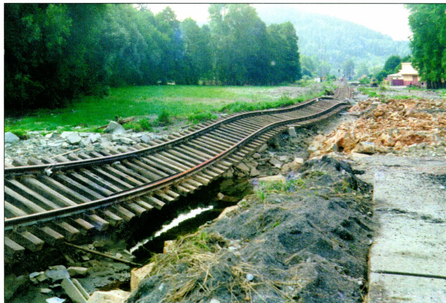
Zničená rychlíková trať u obce Ruda n. Moravou (koryto řeky vlevo za stromy)
