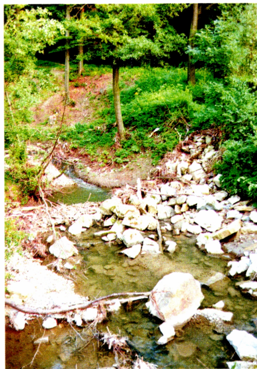
Záběry zničené drátošterkové přehrážky na Veličce u Vápenek
