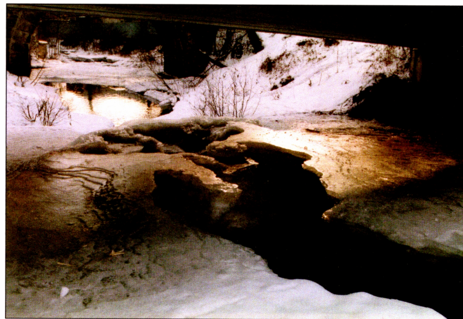
Ledový práh pod mostem v km 32,740; mocnost ledu až 1,0 m – patrná tvorba náledě směrem od proparu (stav 29. 1. 1997)
