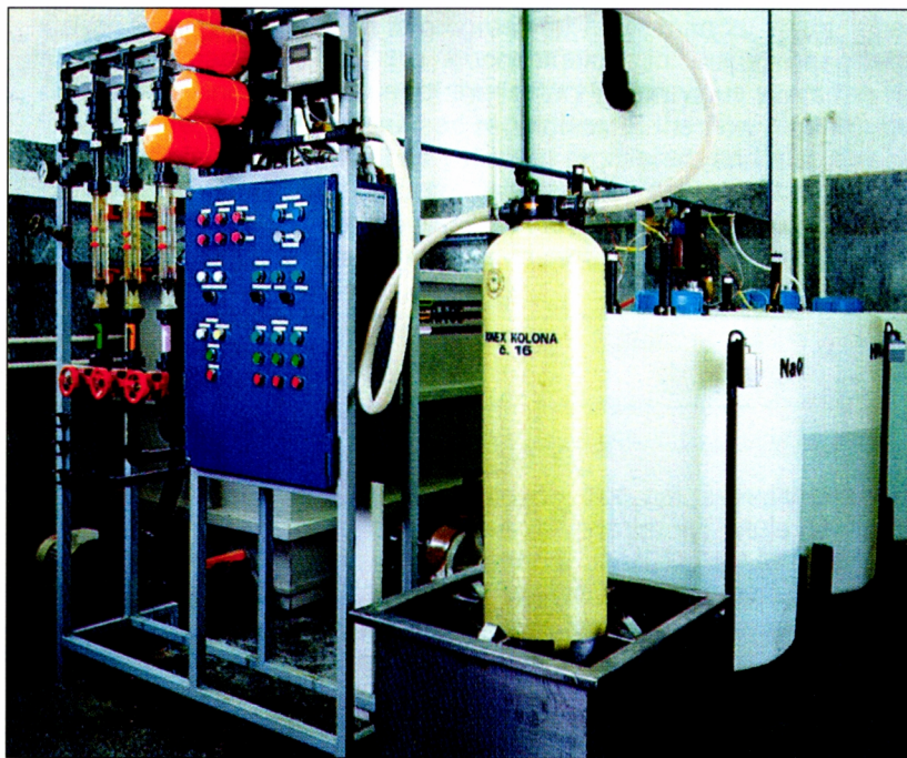
Zařízení na regeneraci ionexových kolon – VaK Havlíčkův Brod
