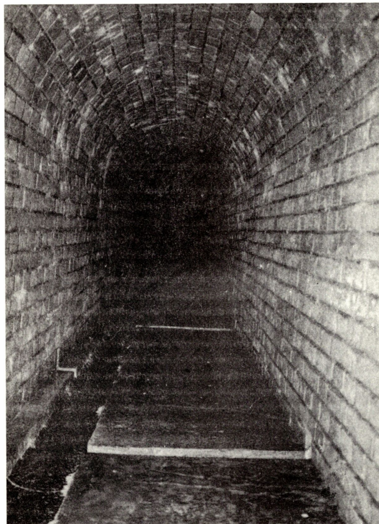
Obr. 14. Štola č. 3: štola se svodným kanálkem u stěny; počva betonová s příčnými žlábkky; vyzděno tvrdě pálenými cihlami (foto J. Štastná)
