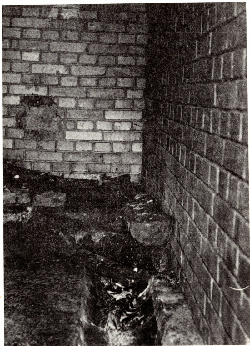
Obr. 17. Štola "Světluška": výtok vody pod cihlovou zdí a kanálek v poč- vě jsou zakryty dřívím a vybouranými cihlami z čelby; technická památká je takto ničena pochybnými živly (foto J. Fuksa)
