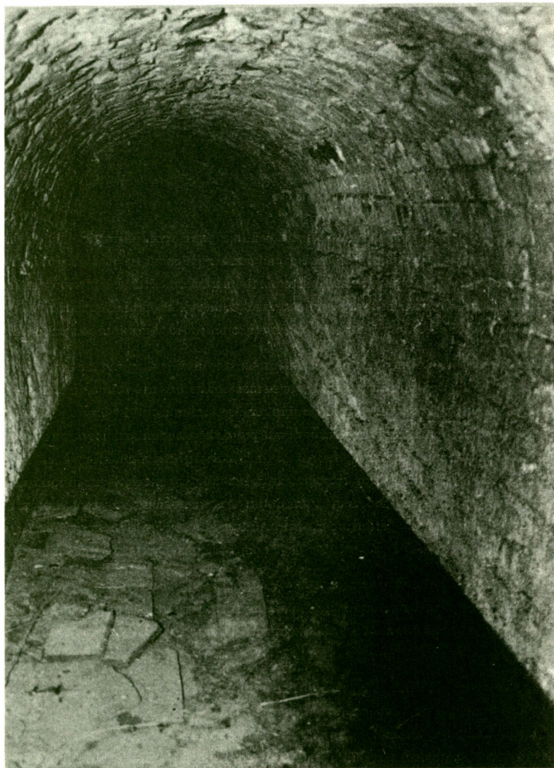
Obr. 9. Štola č. 1 "Královka": vstupní část štoly; smíšené zdivo cihla + kámen; trvale proudící voda; odtok pod zemí do kanalizace (foto J. Fuksa)
