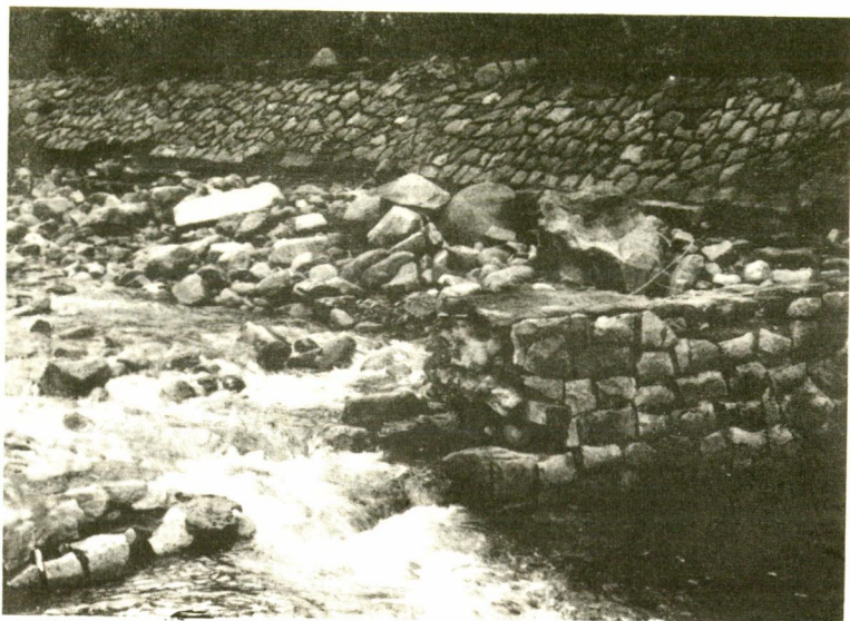
Obr. 1: Zničený stupeň na Labi ve Špindlerově Mlýně
