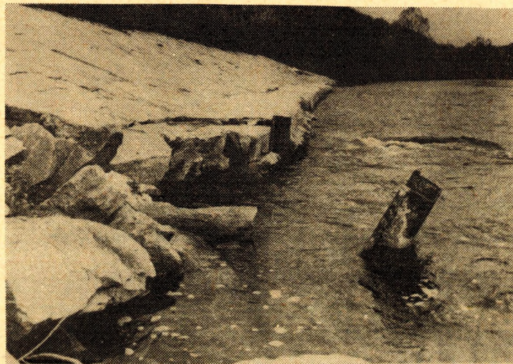
Obr. 7. Rozrušené opevnění v trati nad Hrachoveckým jezem. V pozadí je patrný nenarušený typ opevnění.
