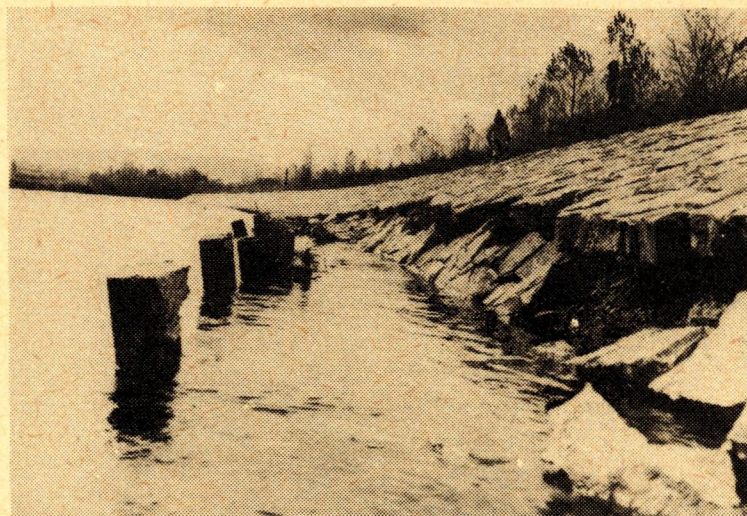
Obr. 6. Rozrušené opevnění v trati nad Hrachoveckým jezem. Výstavba provedena v roce 1967.
