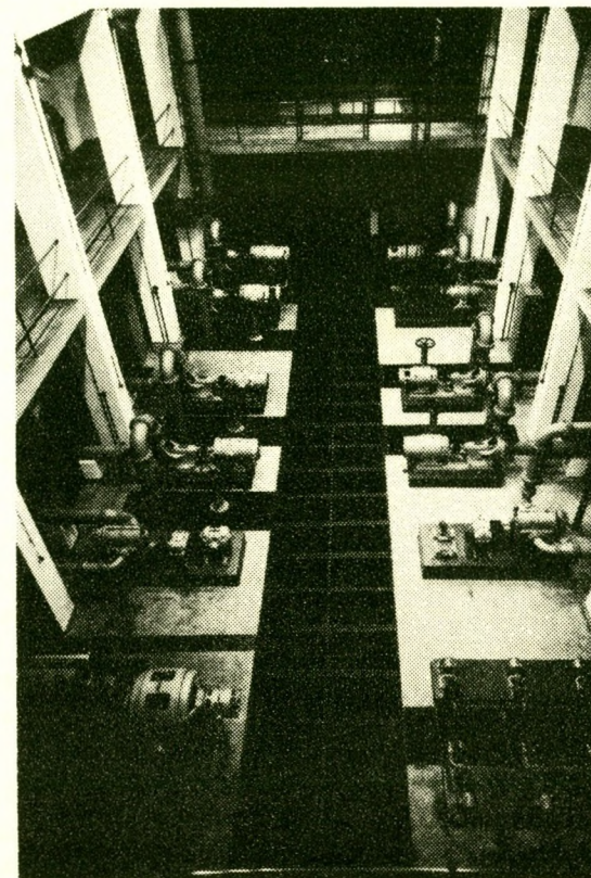
Strojovna úpravný vody v Tlumačově
