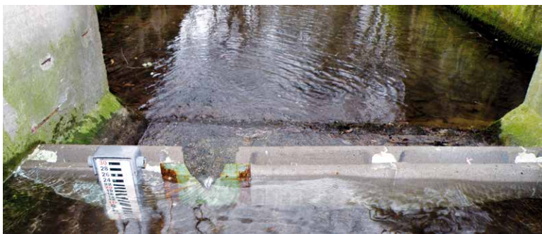
Obr. 4. Vodoměrná stanice P8 osazená Thomsonovým přelivem na štolovém výtoku Skryjského potoka u Dukovan
