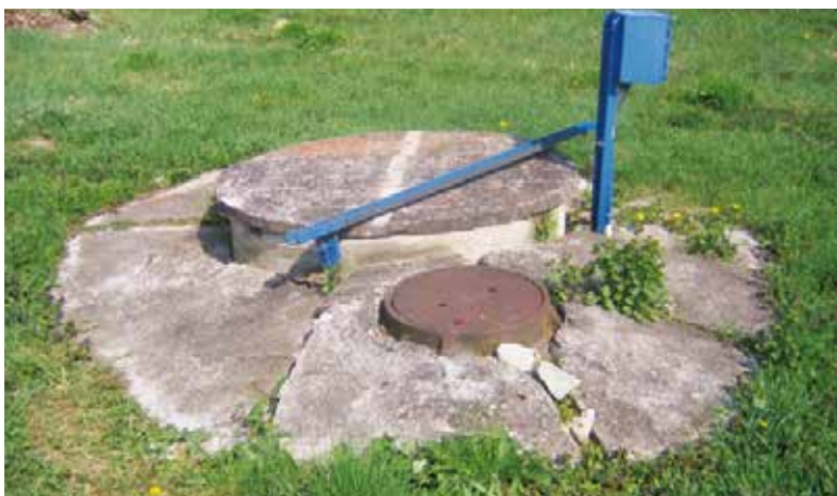
Jímací území Omice – zhlaví čerpací studny
