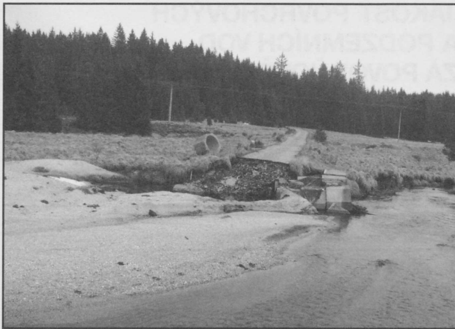
Obr. 6. Následky povodně na horním toku Pohořského potoka, v k. ú. Pohoří na Šumavě
